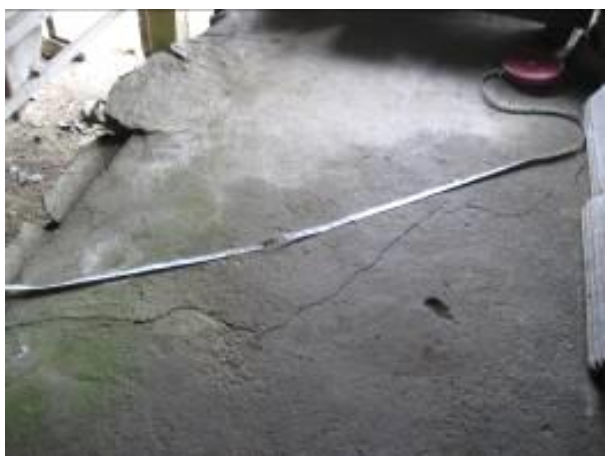
Hình 5. Vết nứt xuất hiện trong nhà dân
