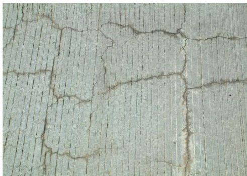
Hình 1. Vết nứt hình thành trong quá trình co ngót
