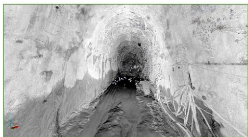
Hình 9.2. Mô hình 3D vị trí xảy ra sự cố sập hầm ( http://www.vinanren.vn/default.aspx?page=tmv_chitiectin&cat=news&zoned=83&lang=vi&contentid=1911 )
