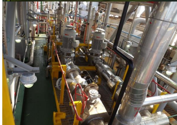
Hình 6. Bể chứa và hệ thống bơm tuần hoàn dầu nóng.
